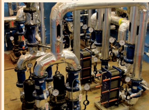
Так выглядит тепловой пункт после реконструкции
